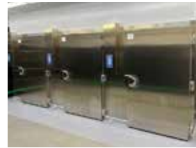
Geräte-Update Neue Chiller installiert Seite 3
